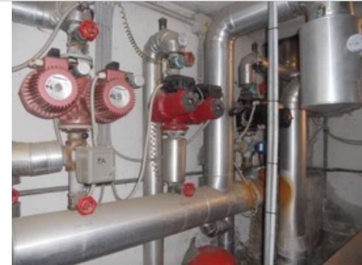
g - pompe centrale termica
